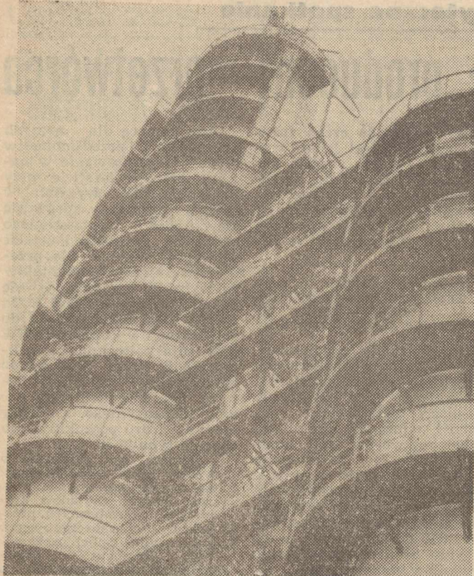
Fragment instalacji rurowo-wieżowej.
