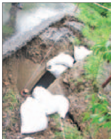
Uszkodzony most w Jamnej
