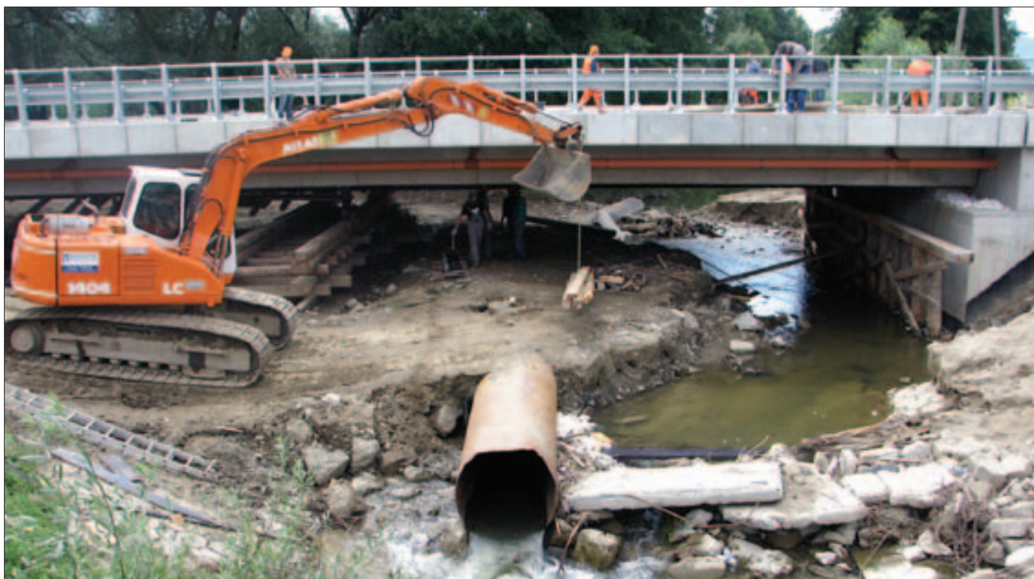
Pod nurtem Paleśnianki umieszczono w tym miejscu rurę kanalizacyjną. FOT. MAREK NIEMIEC
