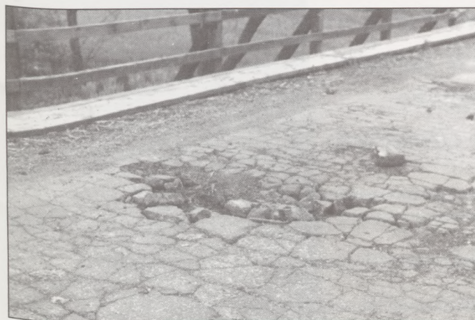
To fragment mostu w Słonej, który od kilku miesięcy prosi się o remont.
