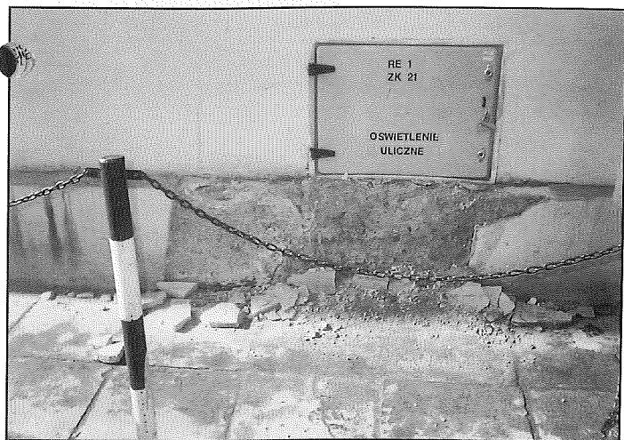
Takich tynków pod skrzynkami jest wiele.
