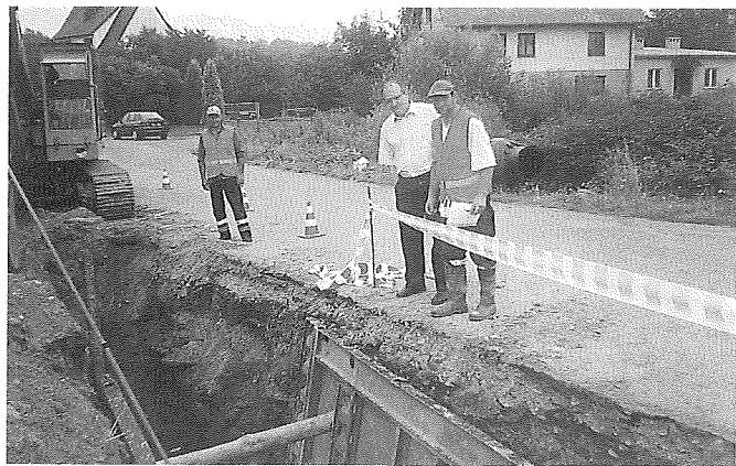
Kolektor kanalizacji w stronę dworku Pendereckiego.
