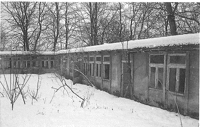
Zdewastowane zabudowania przyszkolne.
