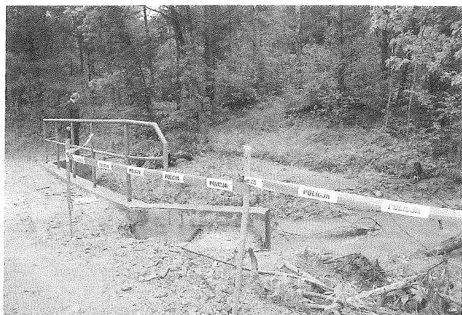
Przy moście w Jamnej obsunęła się ziemia
