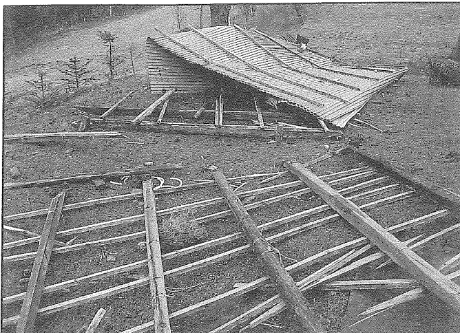
Tyle zostało z pokrycia dachu...
