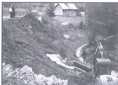
Postępują prace przy osuwisku w Rudzie Kameralnej.
