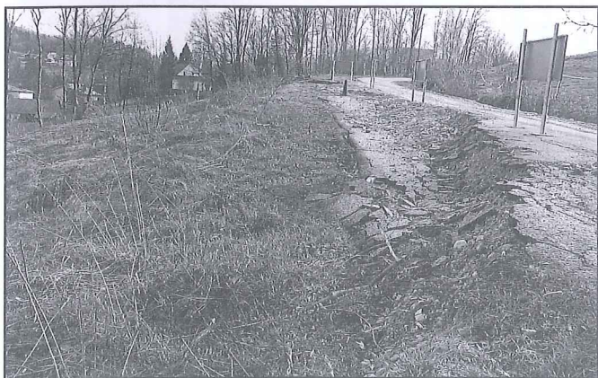
Osuwisko w Paleśnicy przy drodze do Dzierżanin.
