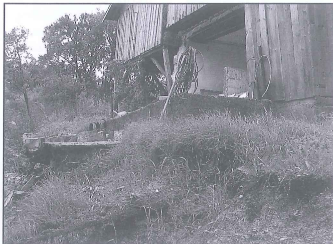
Zabudowania gospodarcze grożą zawaleniem.
