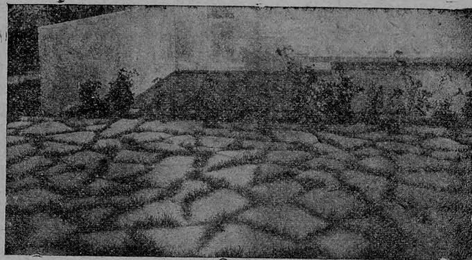
Ryc. 4. Chodnik z połamanych płyt betonowych w szczelinach rośnie trawa
